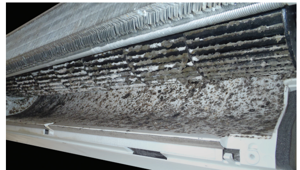
Mini split blower fouled with mold
